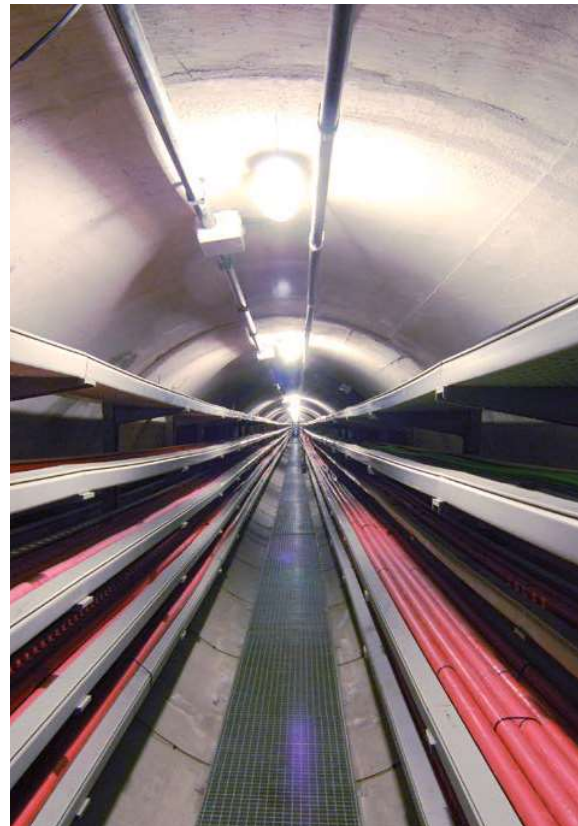
Aeropuerto: galería técnica
