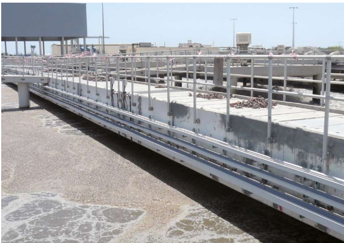
Tratamiento de aguas: EDAR
