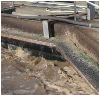
Resistencia a la corrosión
